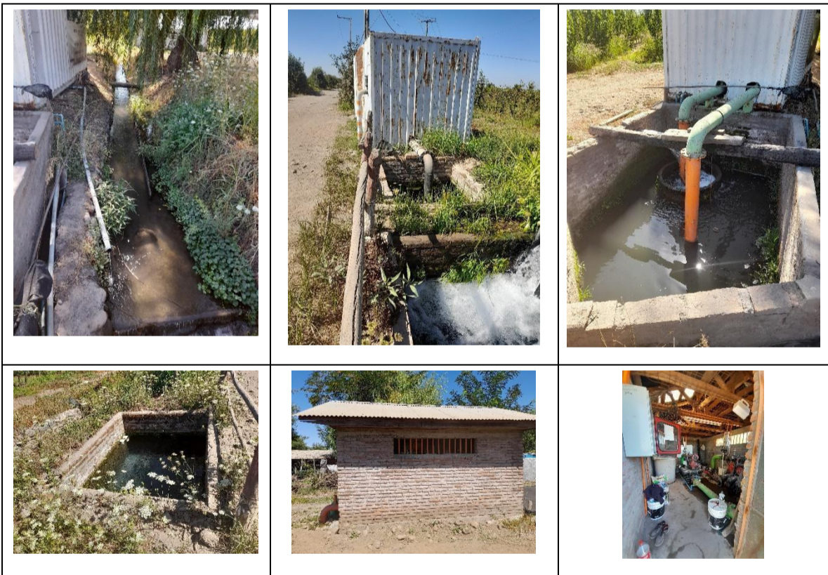
Norias e instalaciones de salas de bomba, lo que permite respaldar la oferta hídrica para riego.
